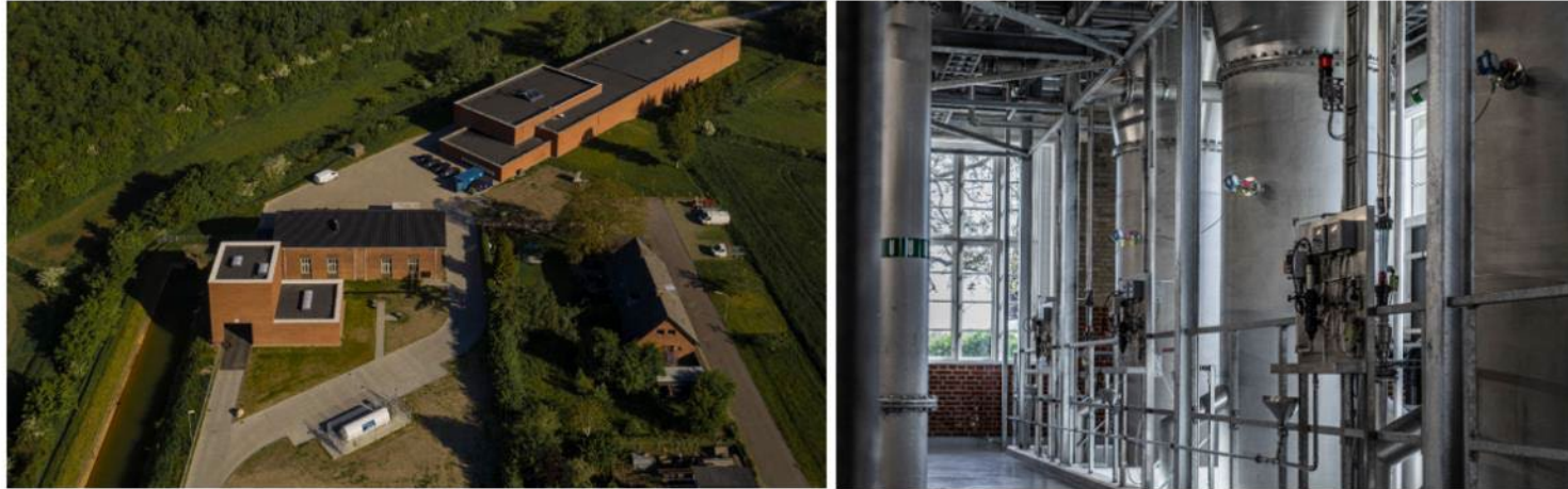
Foto af Værket ved Marbjerg med blødgøringsanlægget i forgrunden samt indvendigt foto af blødgøringsanlægget. Entreprenører: Georg Berg A/S, Wicotec-Kirkebjerg A/S, Uggerly Elinstallation A/S.
